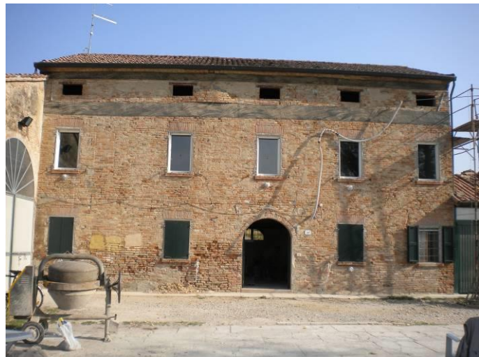
FASCIATURA ESTERNA CON FIBRE DI CARBONIO CERCHIATURA PILASTRO CON FIBRE DI VETRO
